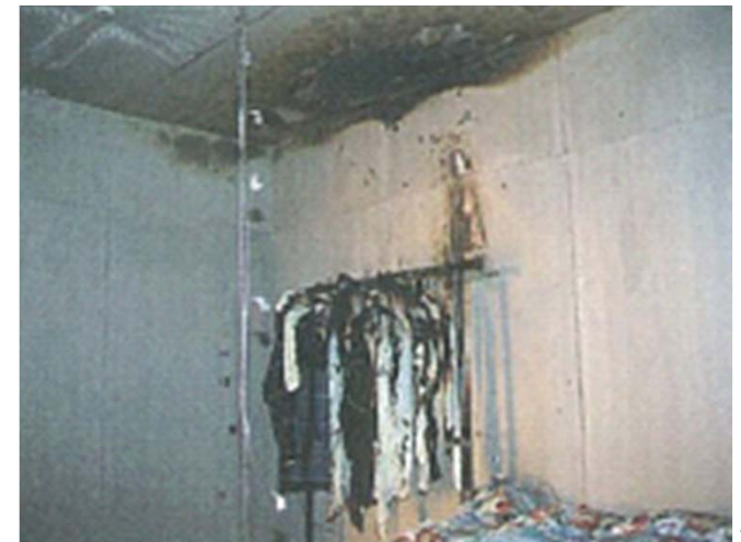
下図: 新たなスプリンクラー設備による消火後の状況
